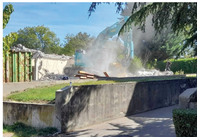
Démolition de l'ancienne école et nostalgie pour les anciens élèves devenus grands
